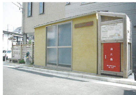
地下貯水槽と手押しポンプ
